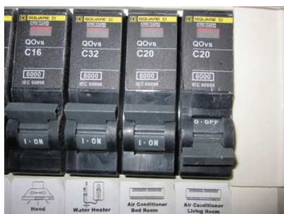
รูปที่ 3.2-2 การปิดสวิตช์เครื่องปรับอากาศ
