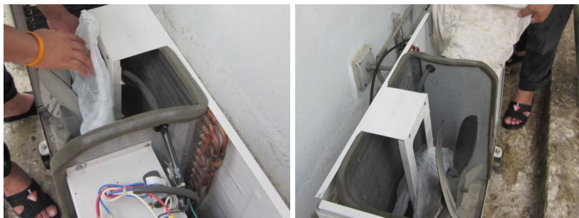
รูปที่ 3.2-19 การหุ้มอุปกรณ์ไฟฟ้า
