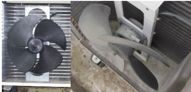
รูปที่ 1.2-7 แสดงมอเตอร์พัดลมคอยล์ร้อน
